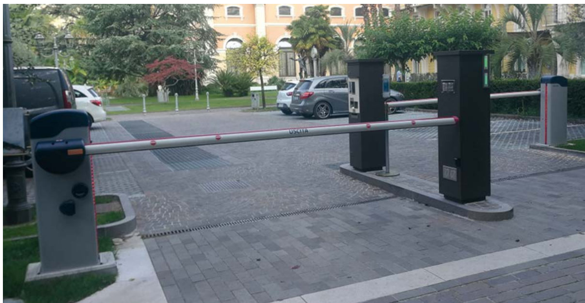
Sbarre (barriere) automatiche alimentate a energia elettrica di 5 m per accesso / di 5 m per uscita
